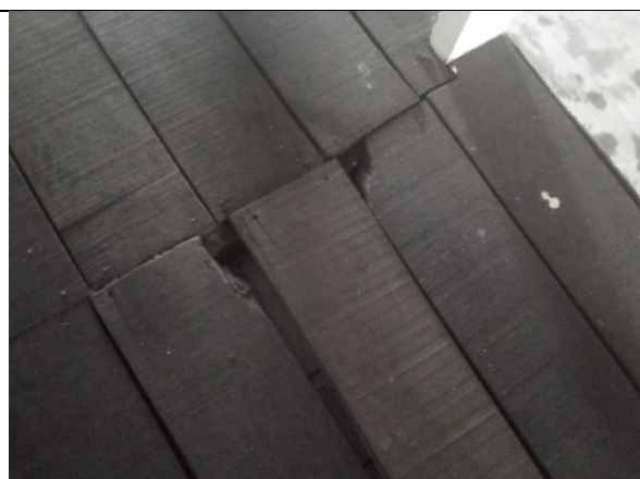
Figura 6 – Tábuas danificadas do piso do mezanino
